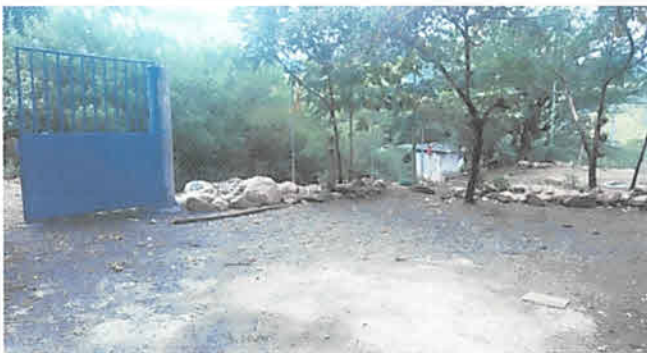
Foto 3: Finalización de cambio de cerco de alambre por muro de malla ciclónica.
